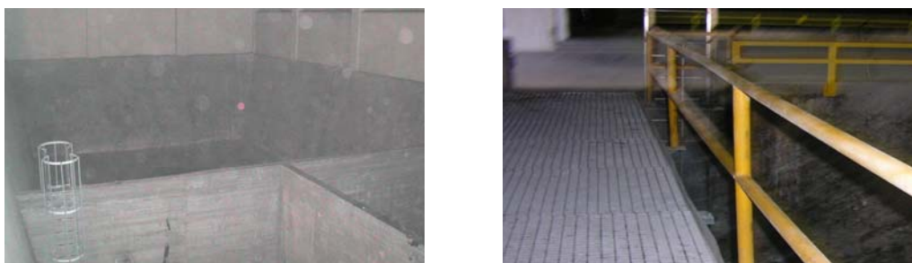
Figura 3 – Células de resíduos não perigosos com respectiva escada de acesso. Pormenor de uma das passareiras que permitem o acesso às células
